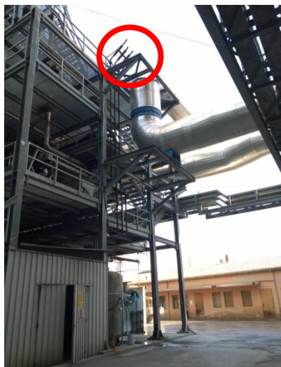
Linea 2: complesso tubiero di scarico vapore
