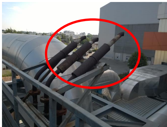
Particolare: sfiato pre-riscaldamento prima delle soffiature
