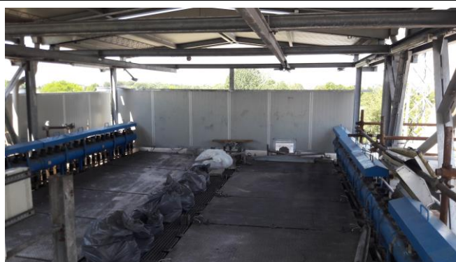
Pannelli schermanti installati lungo la parete ovest
