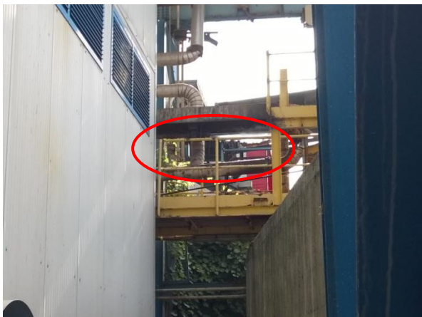
Sistema soffiature caldaia linea 1
