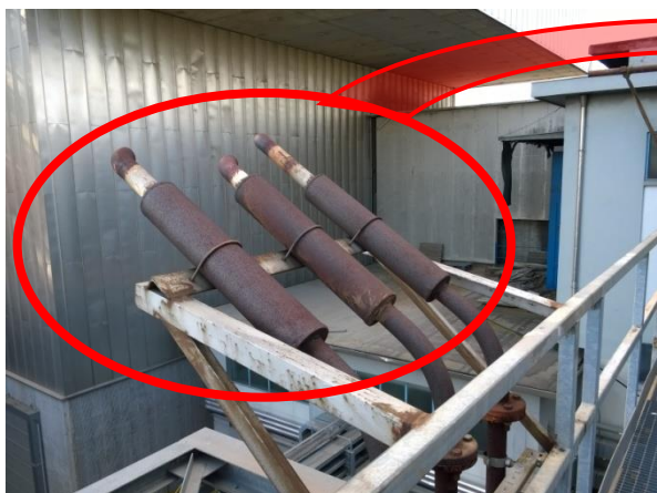
Particolare: sfiato pre-riscaldamento prima delle soffiature
