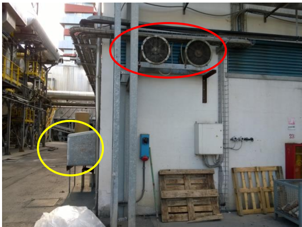
Ventilatori immissione ed emissione aria cabina elettrica
