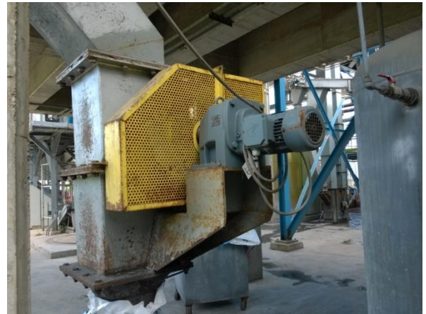
Particolare di una rotocella
