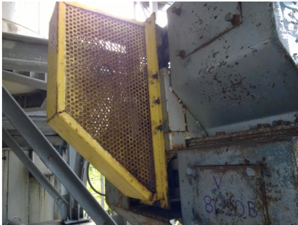
Particolare di una rotocella
