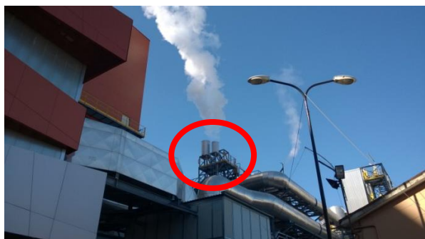
Vista dei silenziatori dal lato nord-est (piazzale principale)
