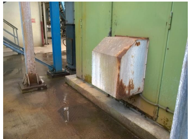
Ventilatore evacuazione fumi linea 1
