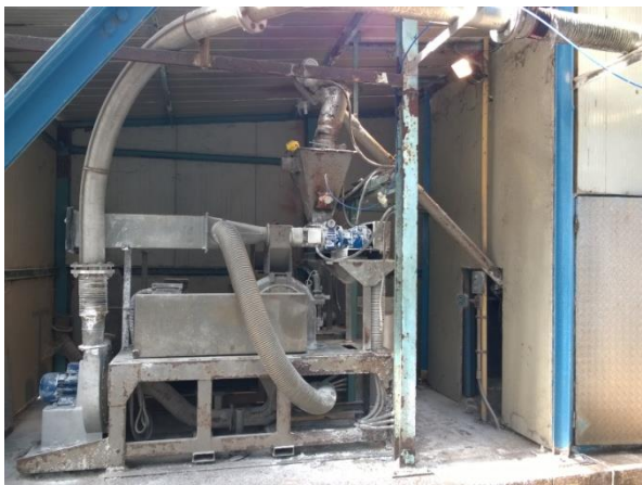
Impianto dosaggio sorbalite linea 1
