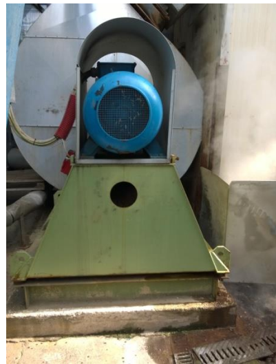
Ventilatore evacuazione fumi linea 1
