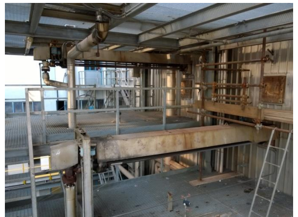
Sistema soffiature caldaia linea 2
