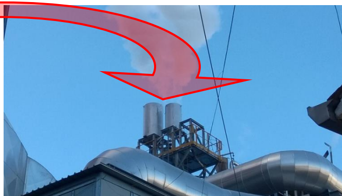
I nuovi silenziatori che ricevono gli sfiati di riscaldamento dei pre-riscaldamenti
