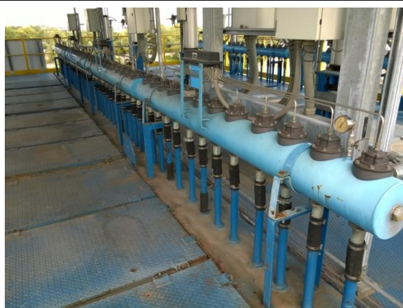
Particolare batteria sfiati filtri a maniche
