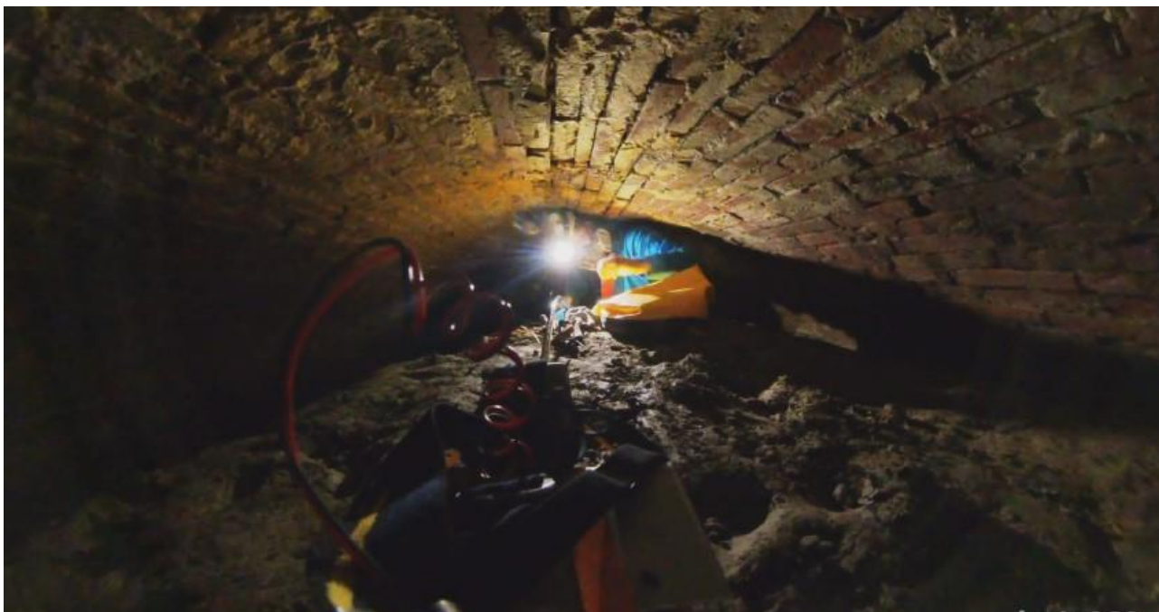
Figura 18-Ultimo tratto rilevabile a causa dell'ostruzione dei detriti
