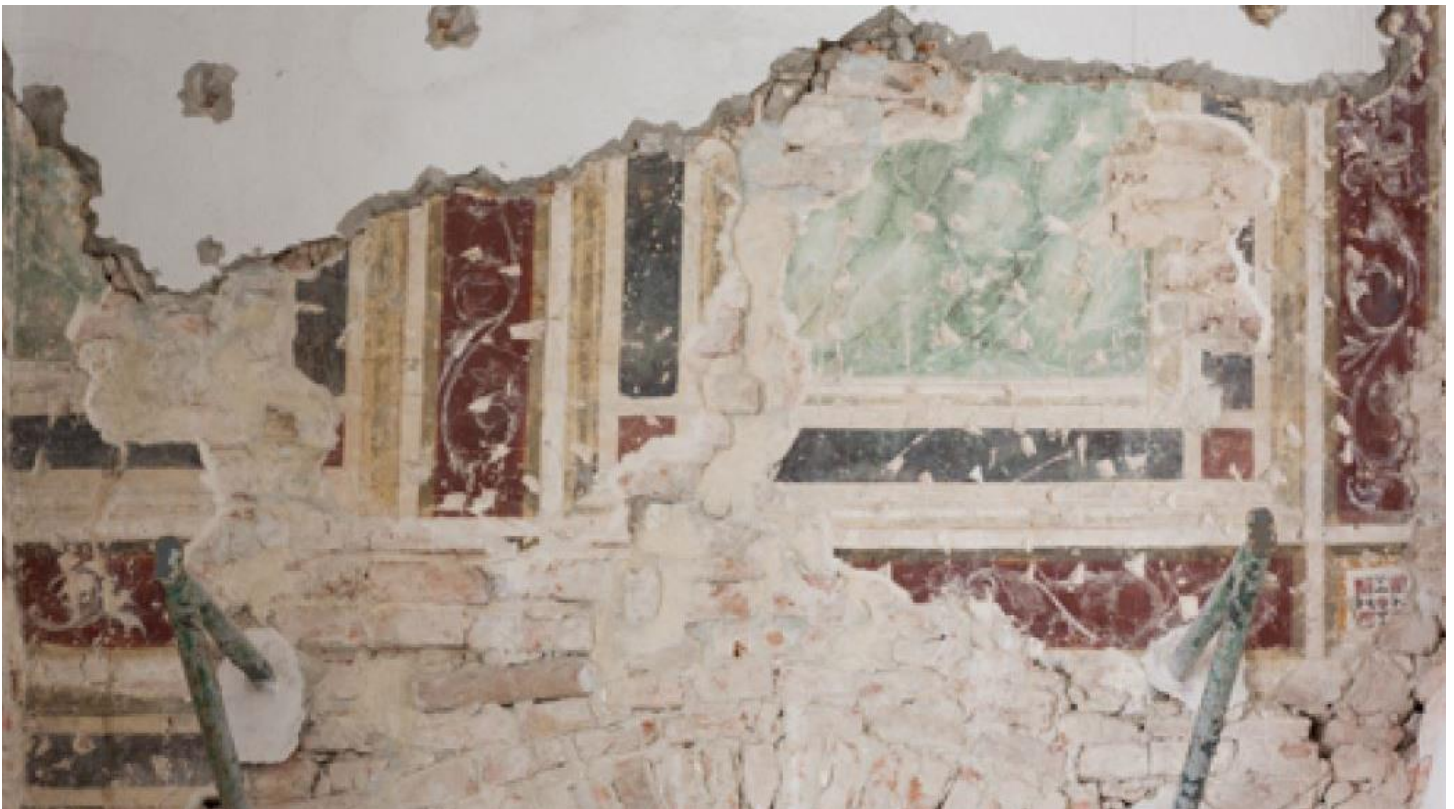
Dettaglio della decorazione del piano primo della loggia, Padova, Castello Carrarese, ala Est
