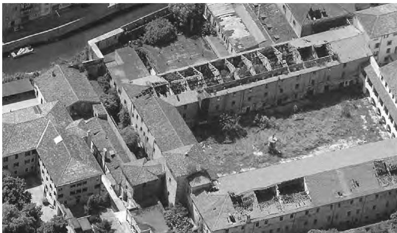
Stato di degrado del Castello, primavera 2005.
