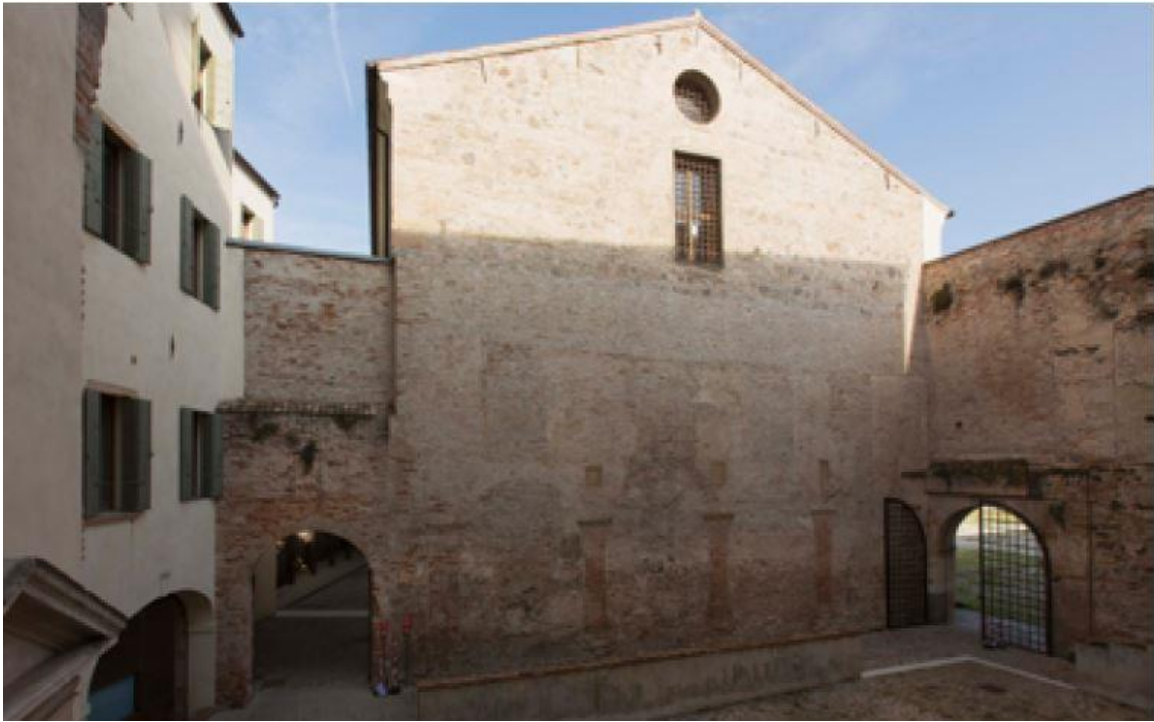
Prospecto meridionale della Casa del Munizioniere, Padova, Castello Carrarese. In evidenza le quattro arcate che costituivano un'antica loggia
