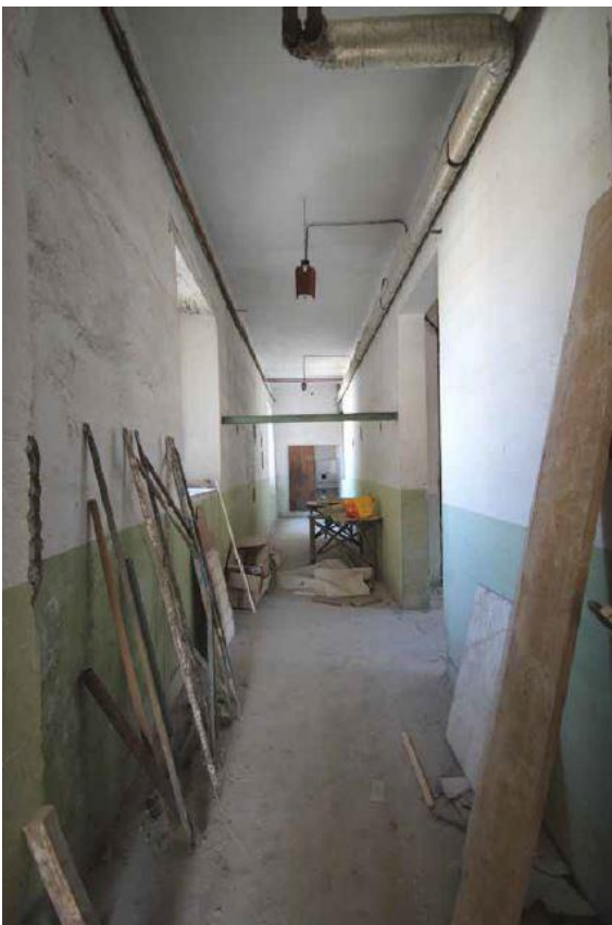
Figura 88 - Vano 01.07.a, ripresa 76.
