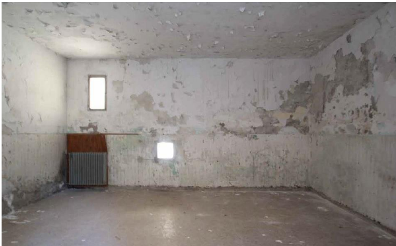
Figura 39 - Vano 00.17.a, ripresa 29.
