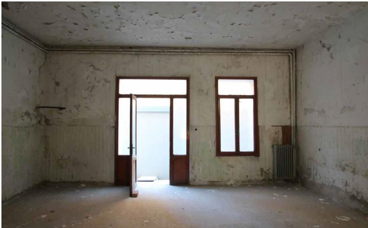
Figura 40 - Vano 00.17.a, ripresa 30.
