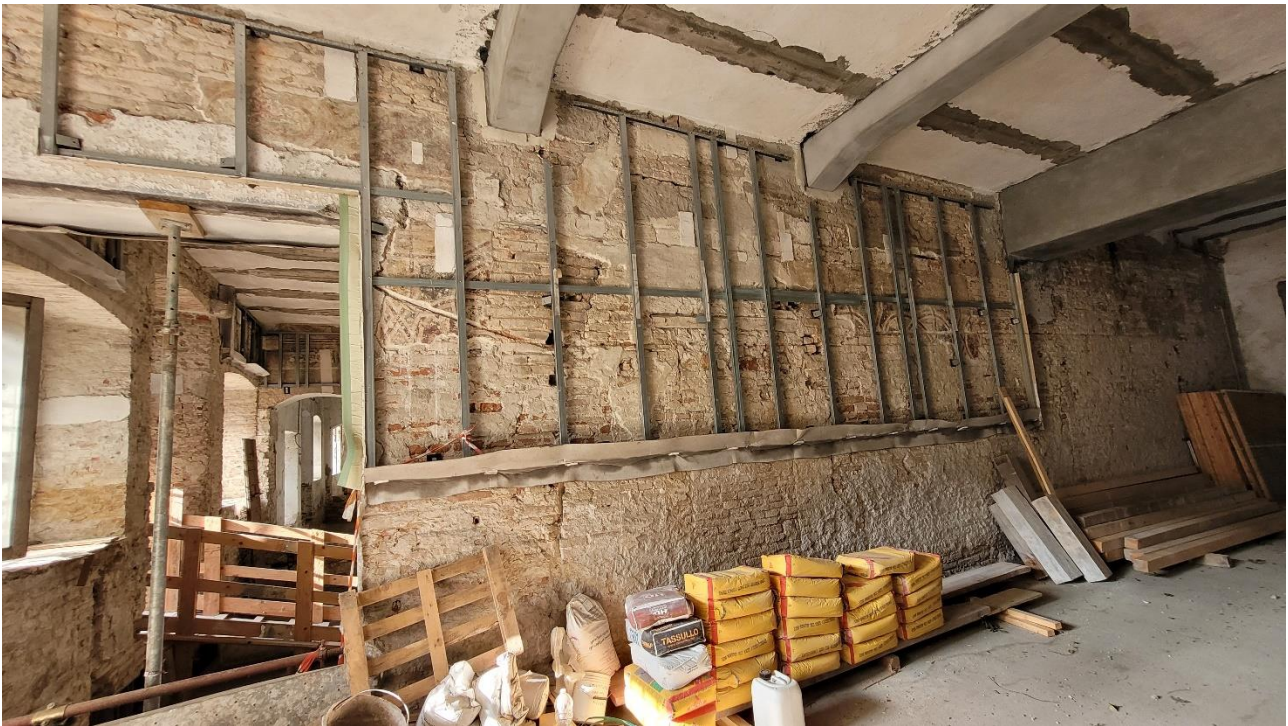
Figura 13 - Vano 00.01, ripresa 3, parete con tracce di affreschi trecenteschi.
