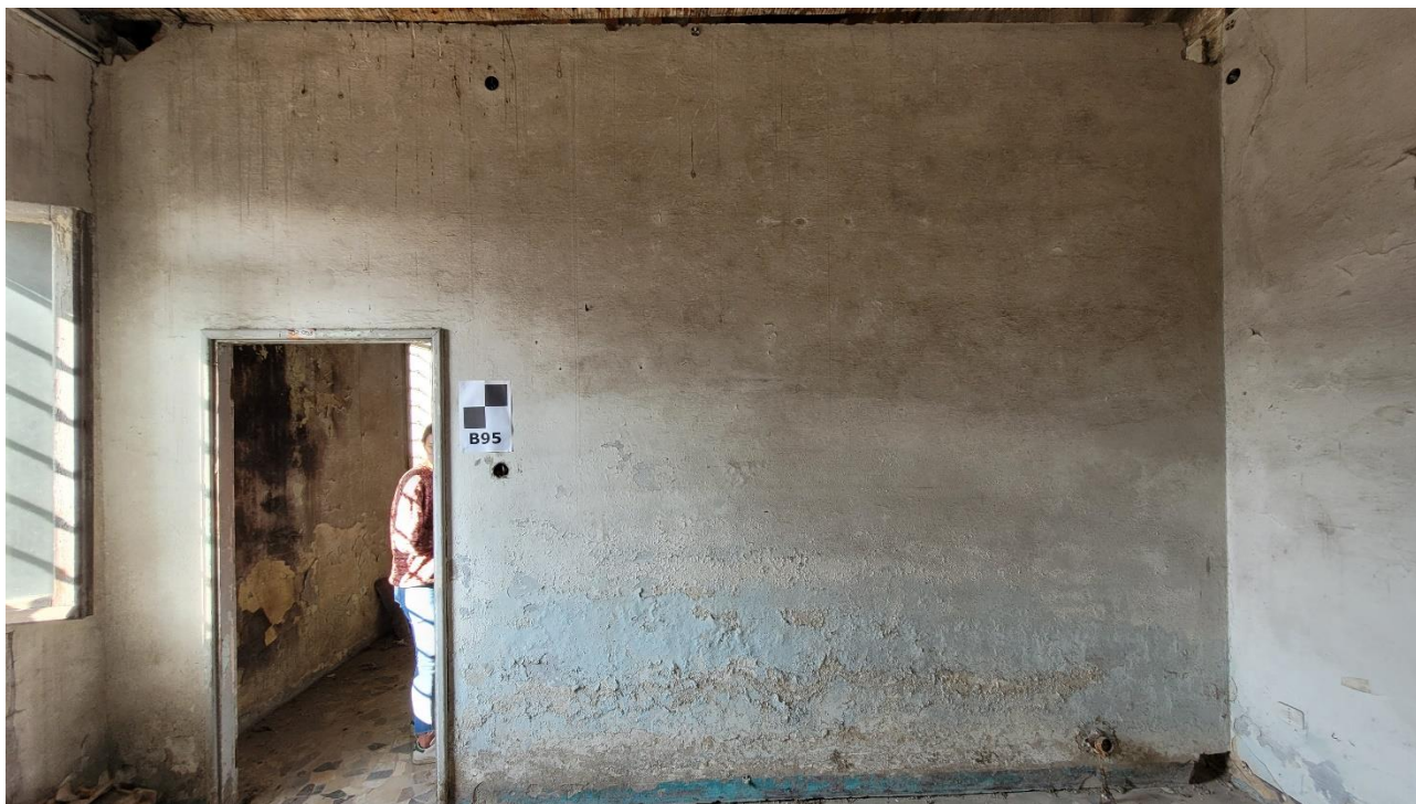
Figura 99 - Vano 02.03.a, ripresa 86.
