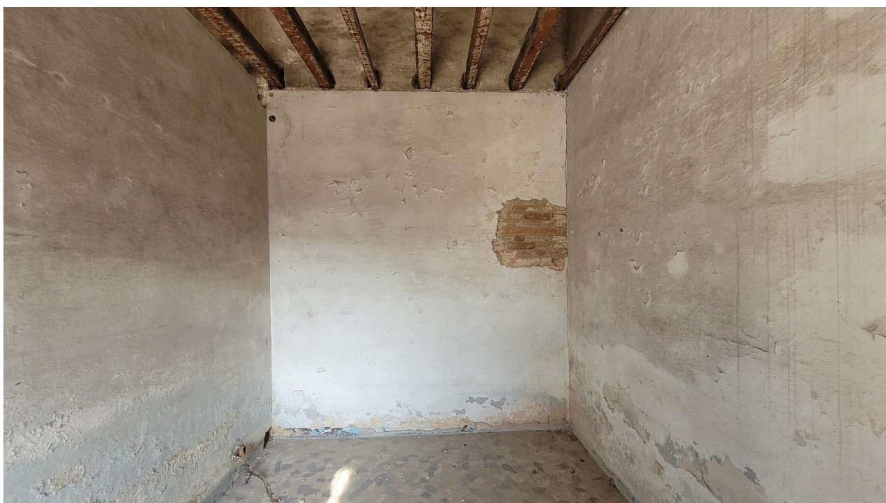
Figura 98 - Vano 02.03.a, ripresa 85.
