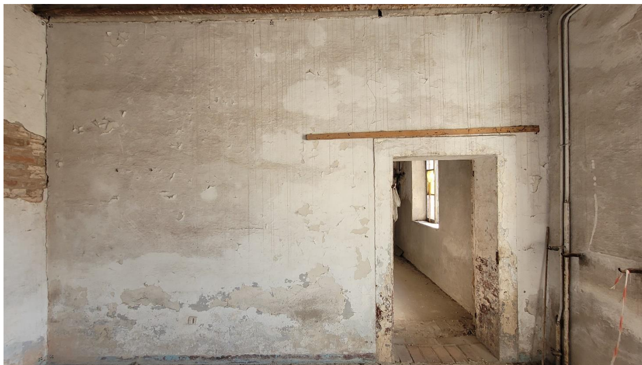
Figura 96 - Vano 02.03.a, ripresa 83.
