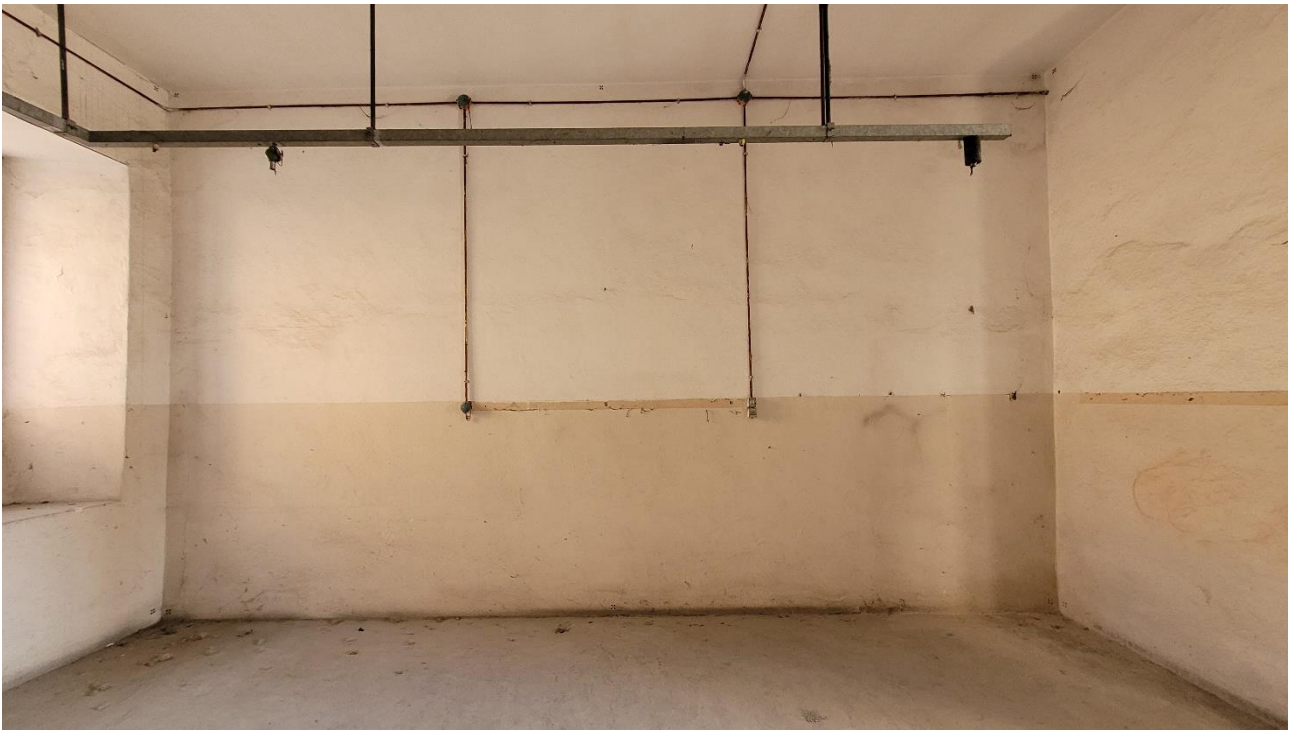
Figura 17 - Intonaci cementizi, stato di fatto
