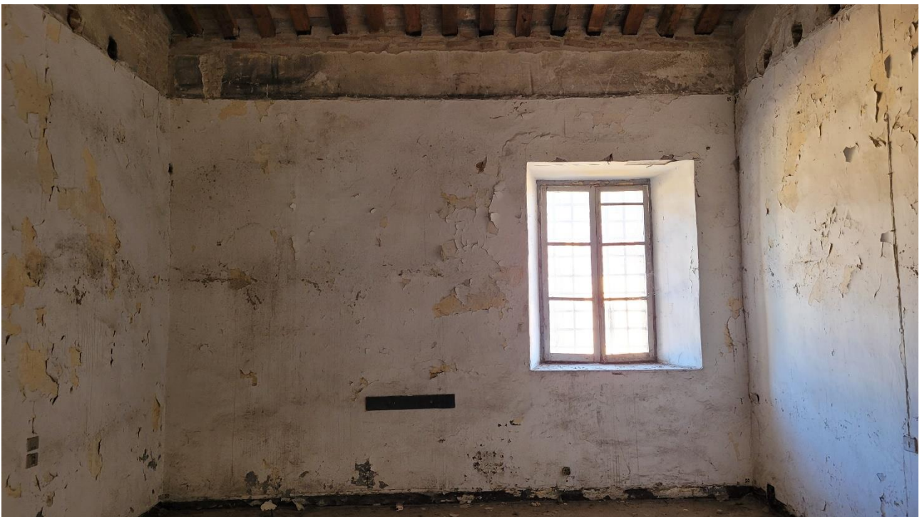
Figura 18 - Intonaci cementizi, stato di fatto
