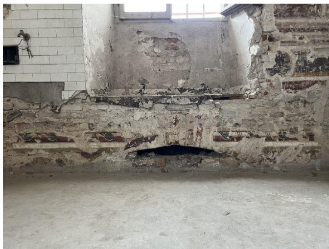
Figura 15 – Continuazione dell'intonaco decorato al piano primo nonostante l'inserimento di un nuovo solaio.
