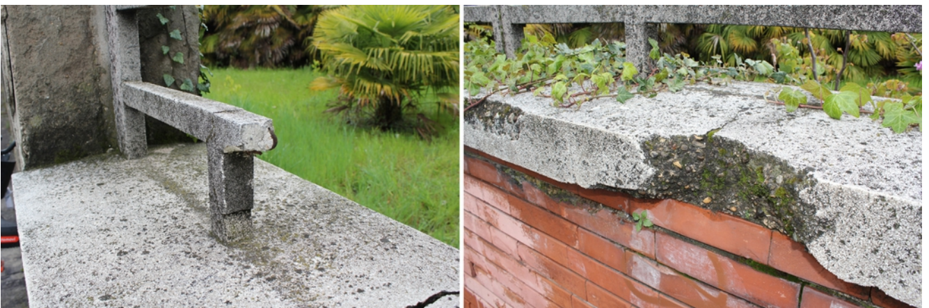
64_LA RECINZIONE SU VIA GUIDO RENI. I MODULI SONO IN CALCESTRUZZO BIANCO A TUTTA SEZIONE; I BANCALINI SONO IN CONGLOMERATO GRIGIO CON RIVESTIMENTO CON PASTINA DI CEMENTO BIANCO, POLVERE E MICROGRANIGLIA DI MARMO
