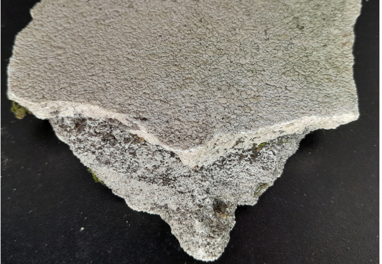
63_FRAMMENTO DEL RIVESTIMENTO PARZIALMENTE STACCATO DEI PILASTRI DEL PORTALE
