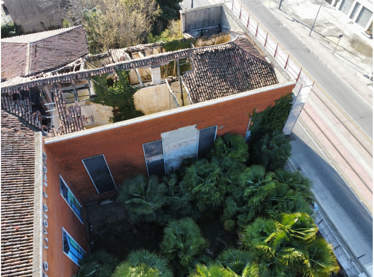
12_FOTOGRAFIA DAL DRONE: ALA SUD, INACCESSIBILE PER GROLLO DI COPERTURA E SOLAI
